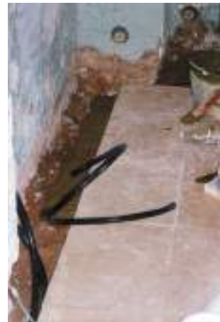
Zanja perimetral en el suelo y junto al muro.
