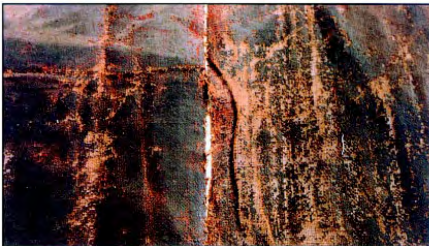
Detalle del deteriorado estado de conservación del soporte.
